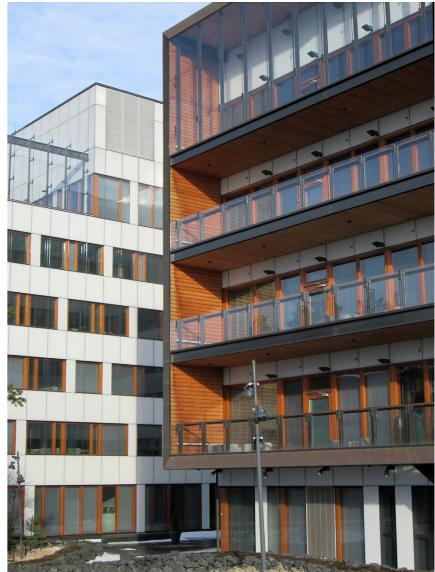
Viistosateen vaikutus puujulkisivuun. Huomaa ero alempien ja ylimmän, lasitetun parvekkeen seinien välillä. Julkisivun suunta länsi, puuverhotun seinän suunta etelä. Tapiola-ryhmän pääkonttori. Valmistumisvuosi 2010. Kuva helmikuu 2014. Kuva Yrsa Cronhjort /AALTO
