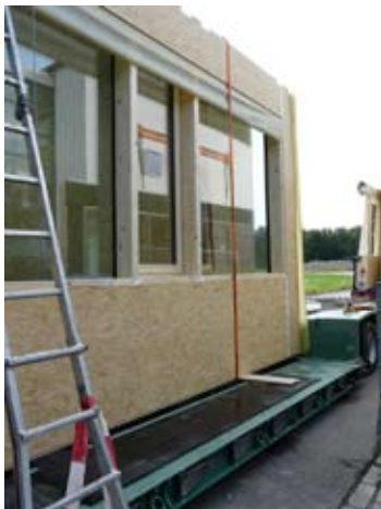
181. TES elements on a trailer.
