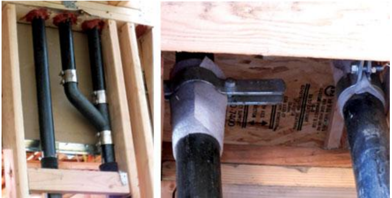
Kuva 21. Viemäriliitoksia, jotka sallivat puunگون painuman.
